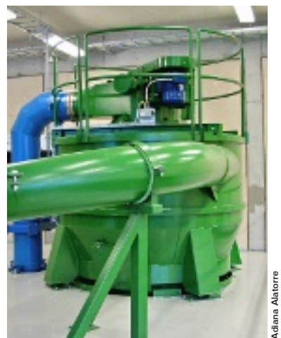
► La red de tuberías que succionan la basura es subterránea.
